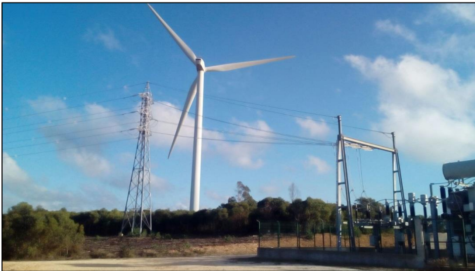
Figura 5 – Subestação existente (parque eólico do Barão de São João) e linha elétrica de interligação existente. Fonte: STRIX
